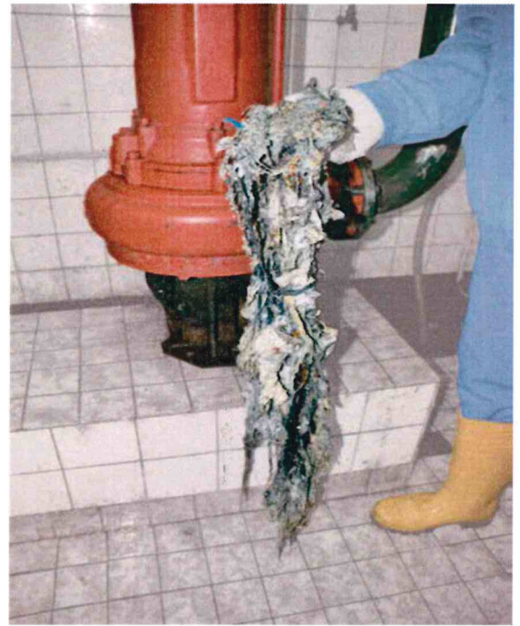
Ein Strang aus verfilzten Feuchttüchern, wie er regelmäßig die Abwassersysteme lahmlegt.
