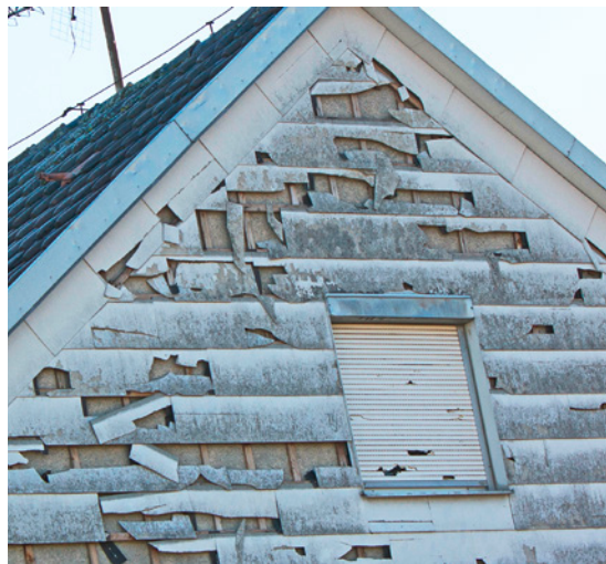
Durch Hagelschlag bruchgeschädigte Fassadenverkleidung aus Faserzementplatten
