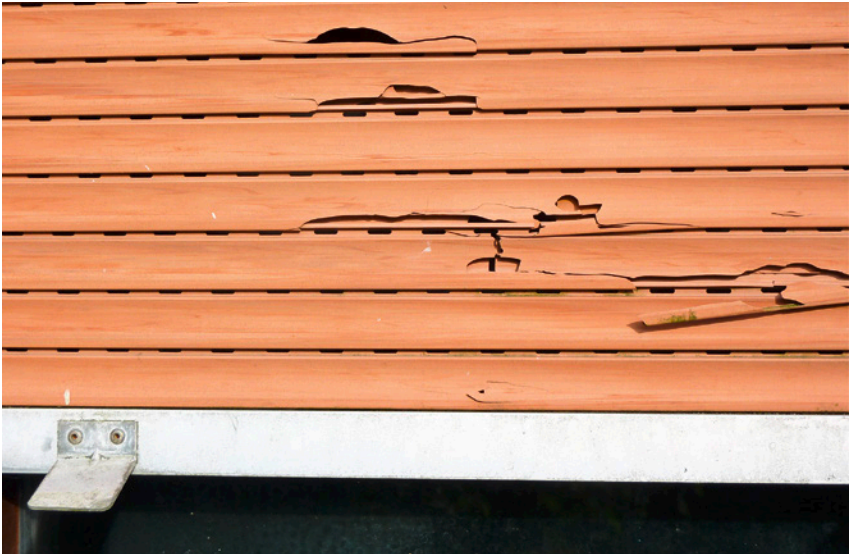
Beschädigter Rollladen aus Kunststoff nach Hagelschlag
