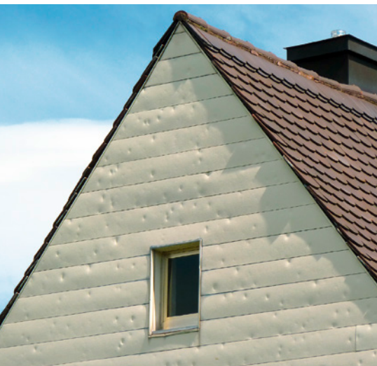
Durch Hagelschlag verformte Fassadenverkleidung aus Metall
